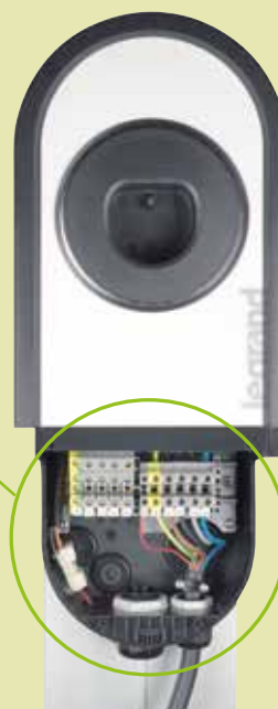
Cableado en la parte inferior
